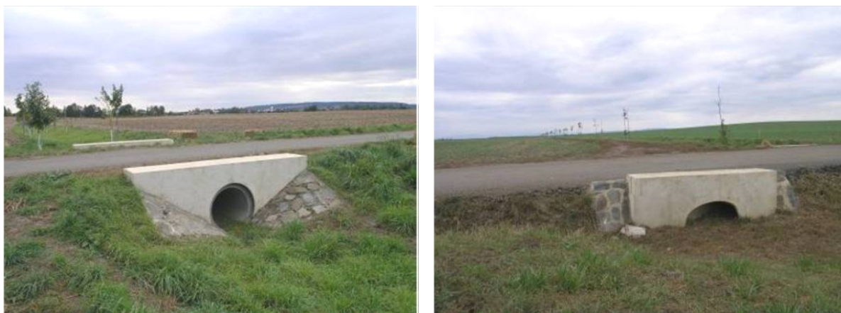
Obr. 6.26 Cestné rúrové priepusty (foto: Muchová, Z.)
